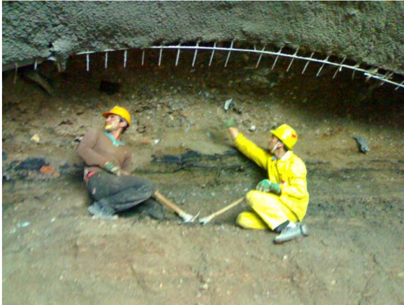
شکل ۵- وجود لایه های لجنی، زباله و مصالح ناهرجا و ساختمانی در جبهه حفاری در تونل دسترسی به تونل قطعه T3-U3
