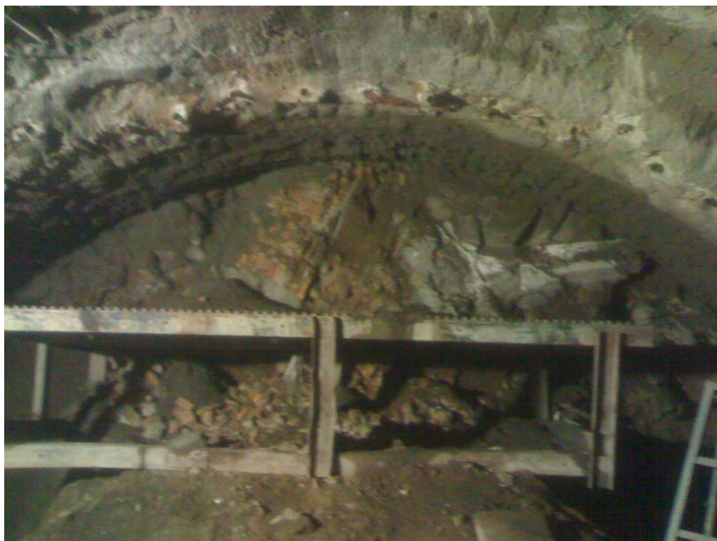
شکل ۱۰- نمایی از پرشدن فضاهای خالی توسط دوغاب در سمت راست تصویر و دیوار آجری ریزش کرده در سمت چپ تصویر در تونل قطعه A4-B4
