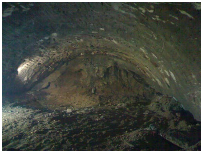
شکل ۸- نمایی از گمانه های تزریق طاق چتری در مقاطع تغییر شکل داده تونل قطعه A4-B4
