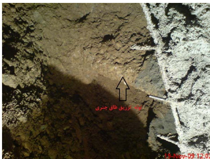
شکل ۱۳- نمایی از ریزش مصالح سربرار بدلیل فاصله زیاد لوله های تزریق از همدیگر در تونل N3
